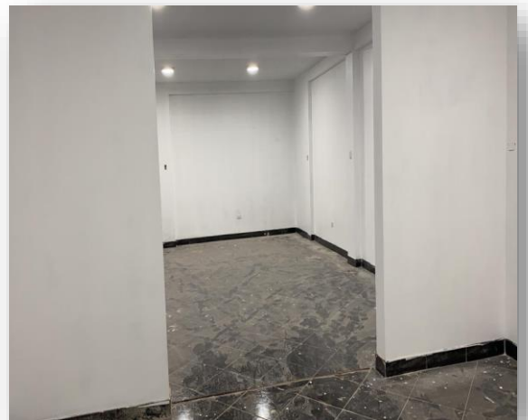
Techos en buen estado, instalación de detectores de humo, luces de emergencia, instalaciones eléctricas en buen estado
