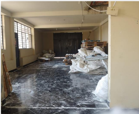
Techo en mal estado, pisos desnivelados, cableado expuesto
