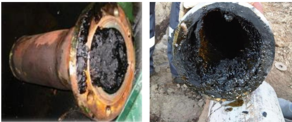
Figura 1. Tuberías obstruidas por formación de sedimentos [36].
