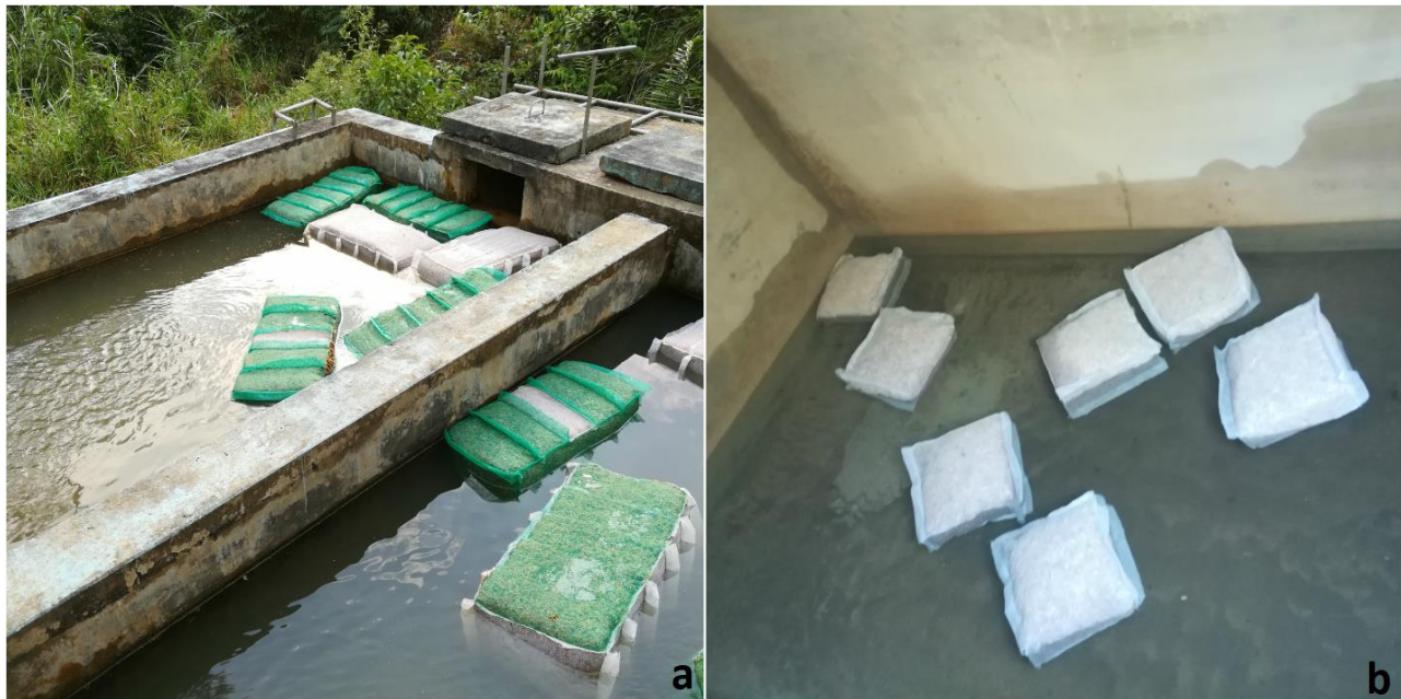
Figura 13.- Biofiltros instalados en los reservorios de a) Tzancuvatzari (cinco cartuchos) y b) de San José de la Florida y Santa Rosa de Cashingari (un cartucho).
