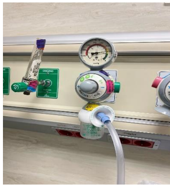
Figura 17. Verificación del funcionamiento del equipo y regularización de la presión
