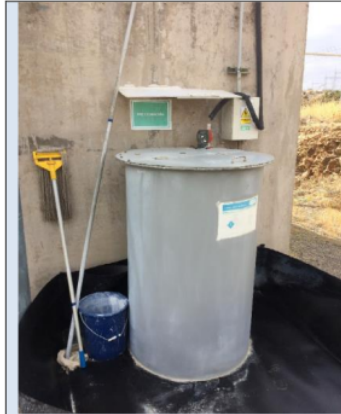
Dosificador de Cloro (precloración)
