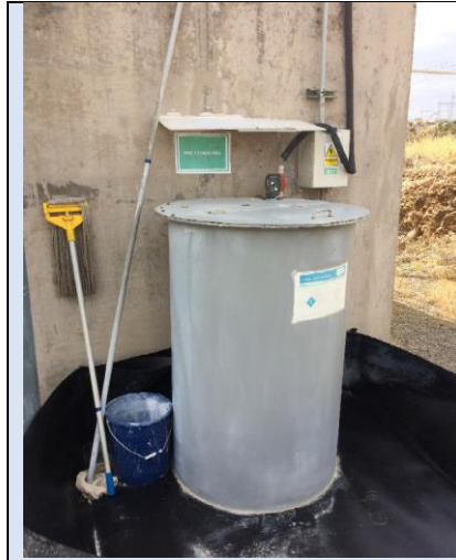
Dosificador de Cloro (precloración)
