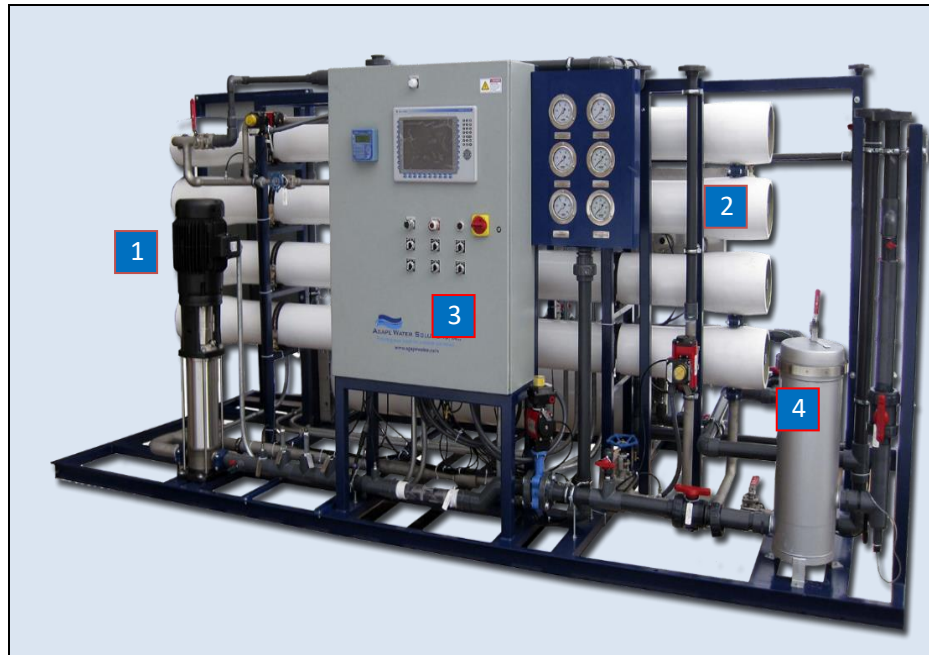
Fotografía Sistema de Ósmosis Inversa: 1: Bomba de alta presión; 2: Carcasas con membranas; 3: Tablero de control y 4: Filtro submicrónico.
