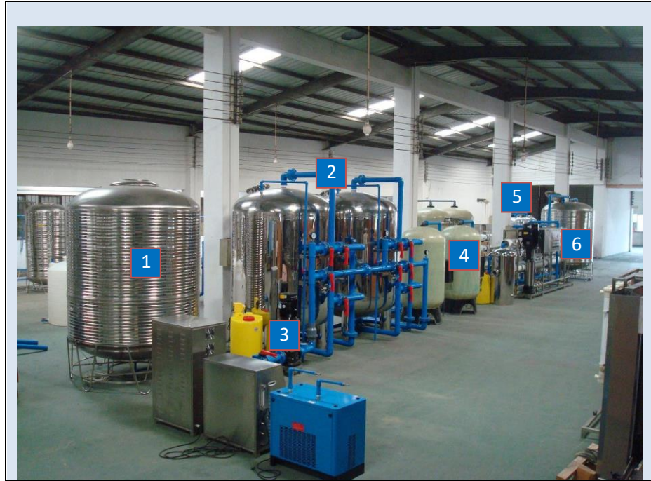
Equipos complementarios: 1. Tanque de alimentación 2. Sistema de filtración, 3. Dosificador 4. Sistema de ablandamiento, 5: Sistema de Ósmosis Inversa. 6: Tanque de producto.
